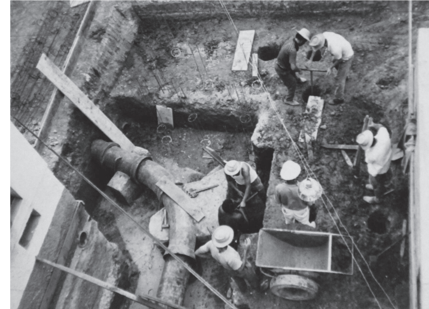
Construção da nova casa de bombas durante reforma e ampliação da Estação de Captação de Água (1970)
