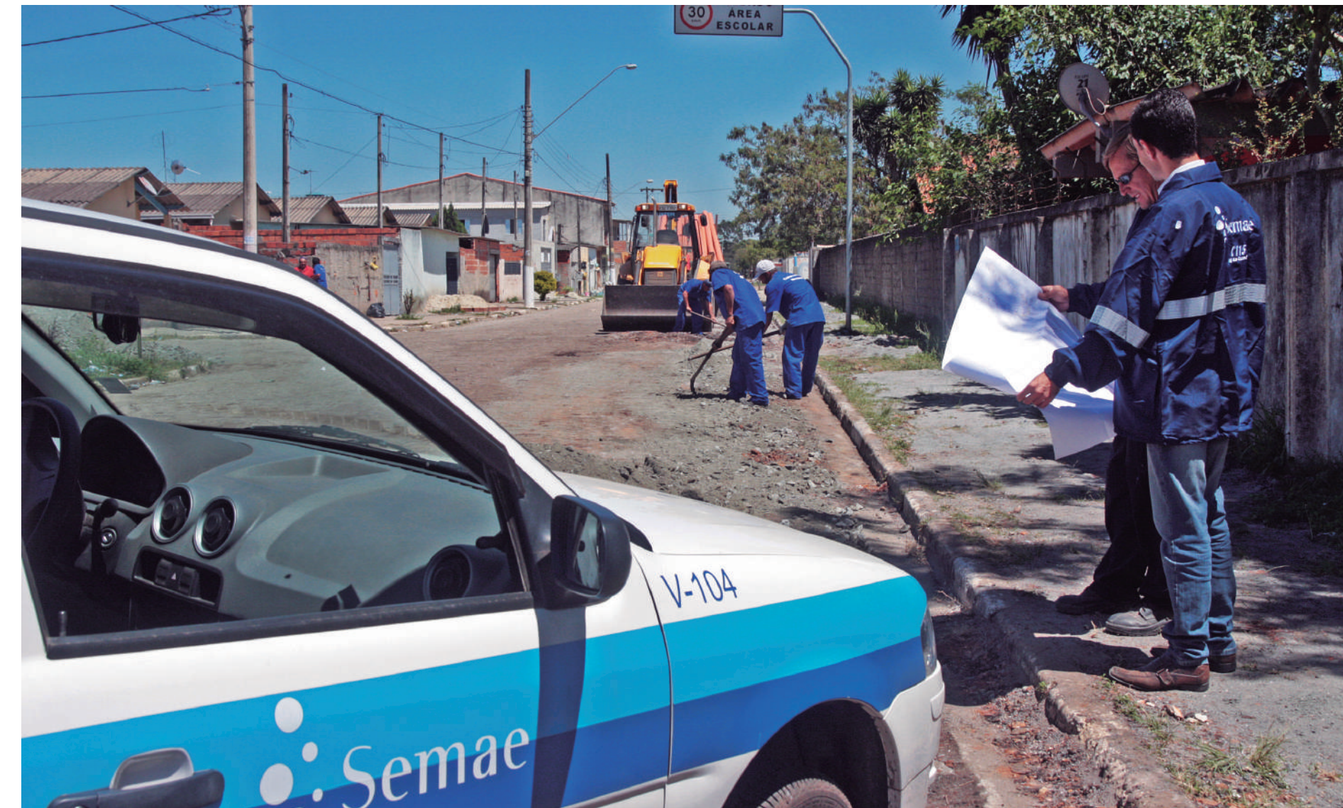
Ruas de Jundiapéba foram beneficiadas com ampliação das redes de água e esgoto
