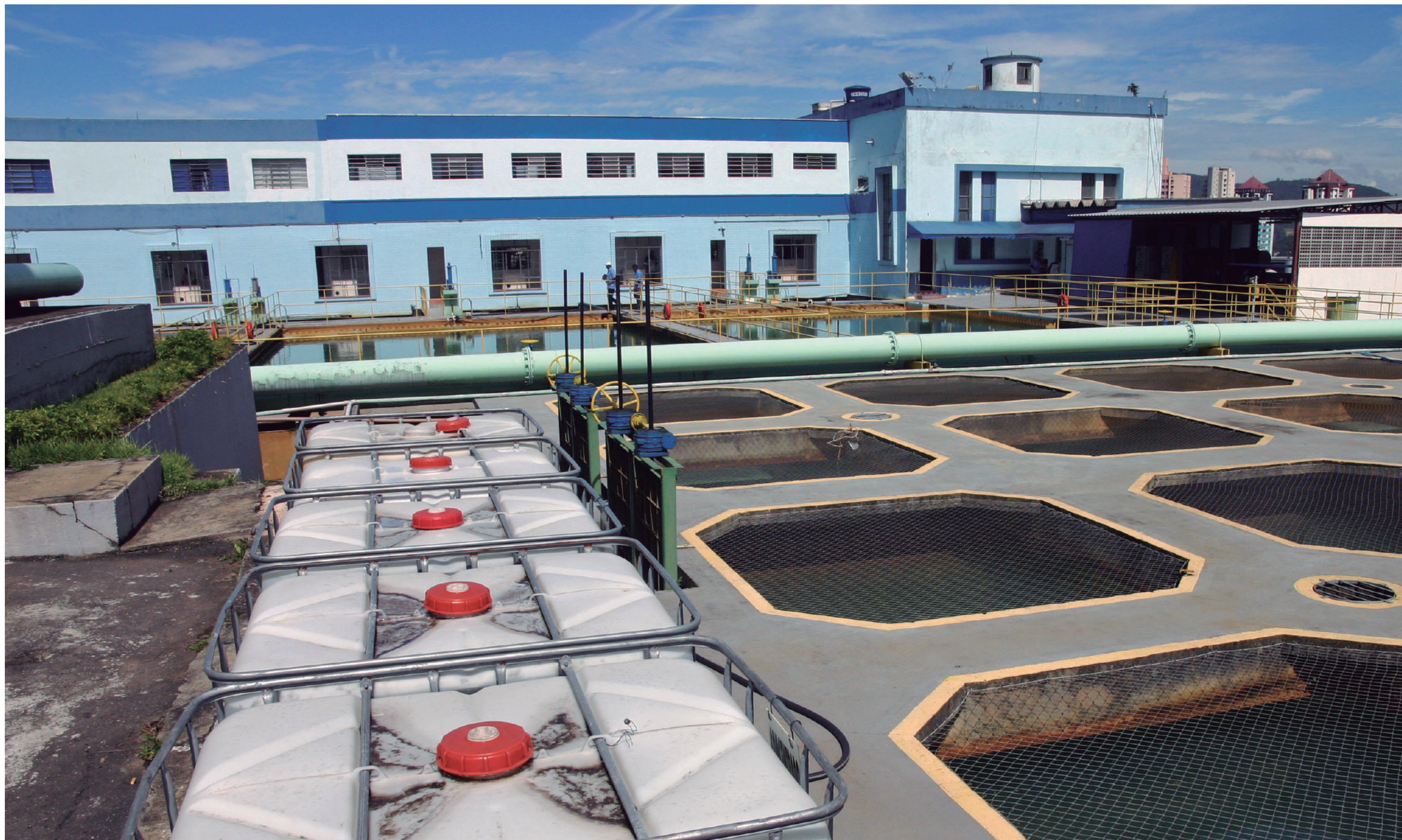
Na área de abastecimento, Estação de Tratamento de Água (ETA) Centro passa por modernização
