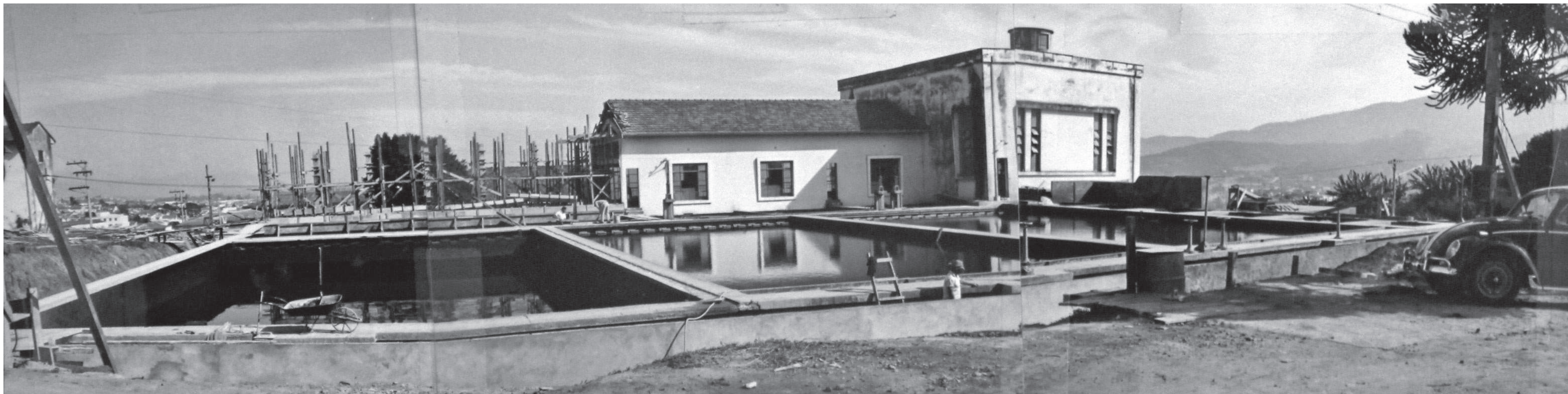
Estação de Tratamento de Água de Mogi das Cruzes, entre as Ruas Otto Unger e Senador Dantas, em 1969, quando a estrutura estava passando por reformas para ampliar a capacidade de operação para acompanhar o crescimento da cidade e o aumento da população
