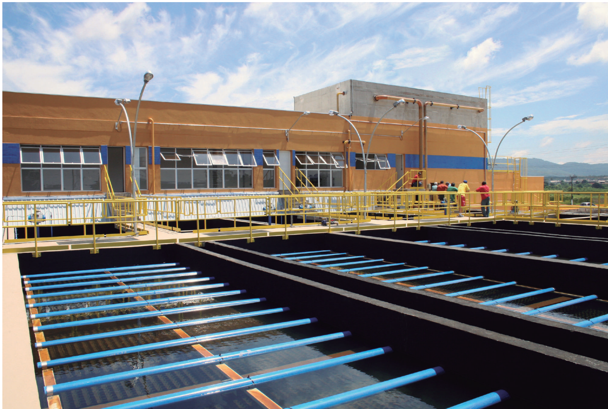
Com a ETA Leste concluída e em operação, o Semae reduziu a dependência da Sabesp e aumentou sua autonomia no tratamento e distribuição de água
