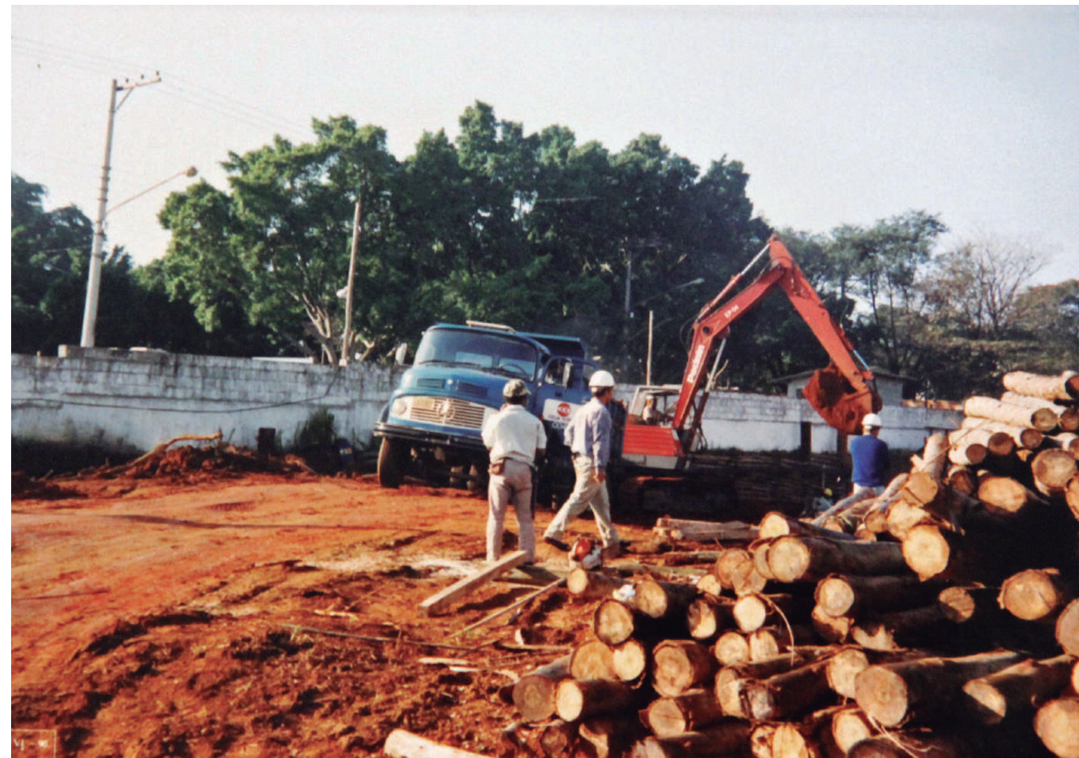
Escavações e escoramentos da obra de ampliação da Estação de Tratamento de Água da Rua Otto Unger, a principal do Semaes (início dos anos 1990)
