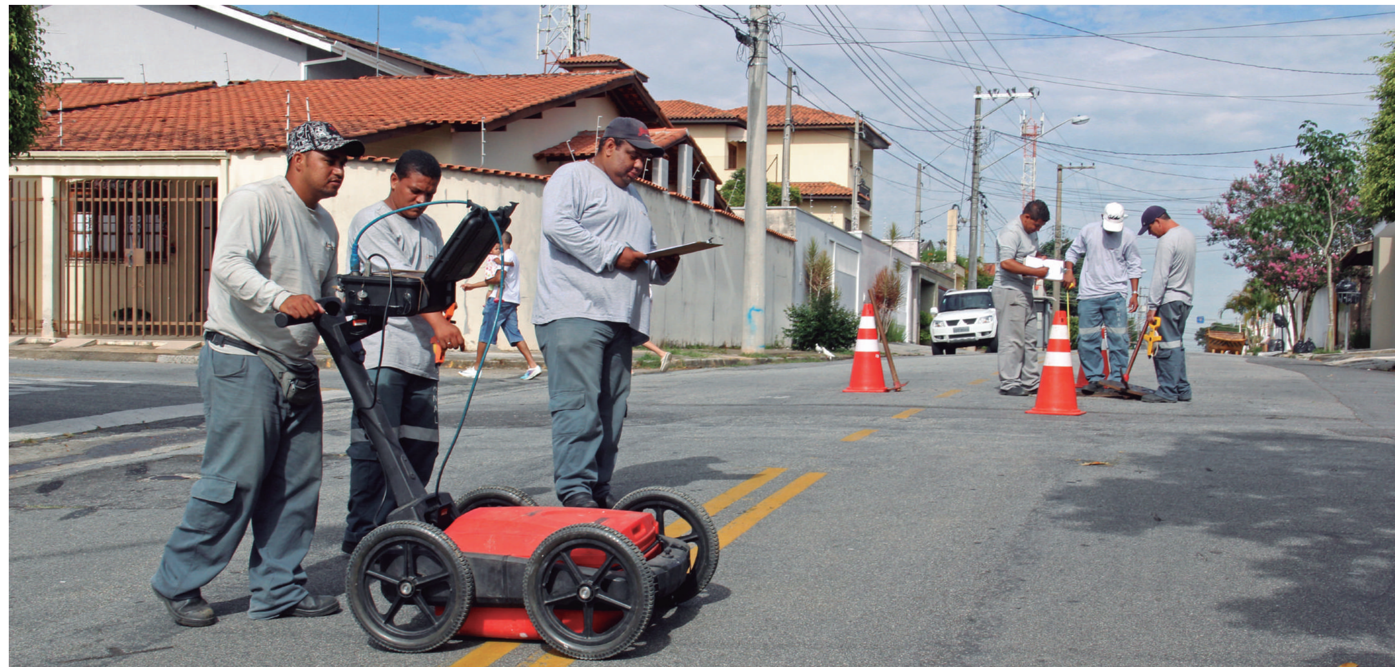
Recadastramento digital mapeou todas as redes de água e esgoto de Mogi das Cruzes. Acima, trabalho é realizado em rua da Vila Oliveira (2012)
