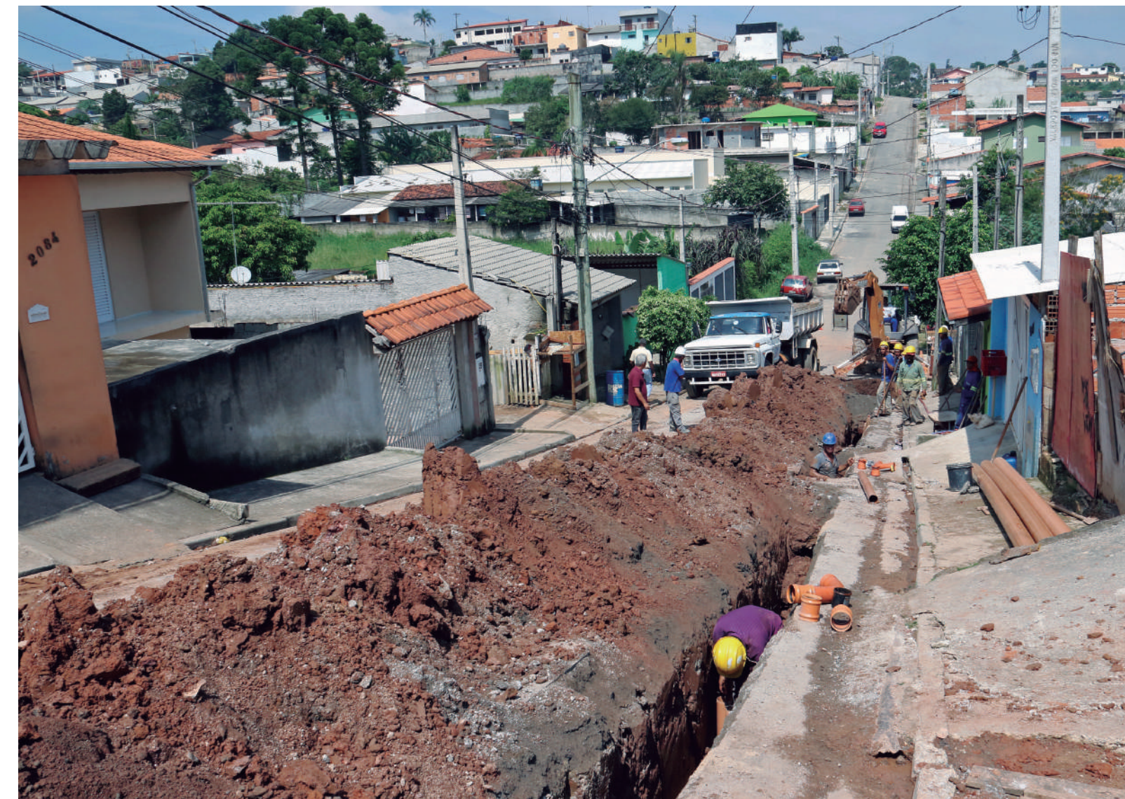
Último grande bairro de Mogi das Cruzes que ainda não contava com sistema de coleta e tratamento de esgoto, Botujuru ficará 100% saneado e população deixará de conviver com fossas e esgoto a céu aberto
