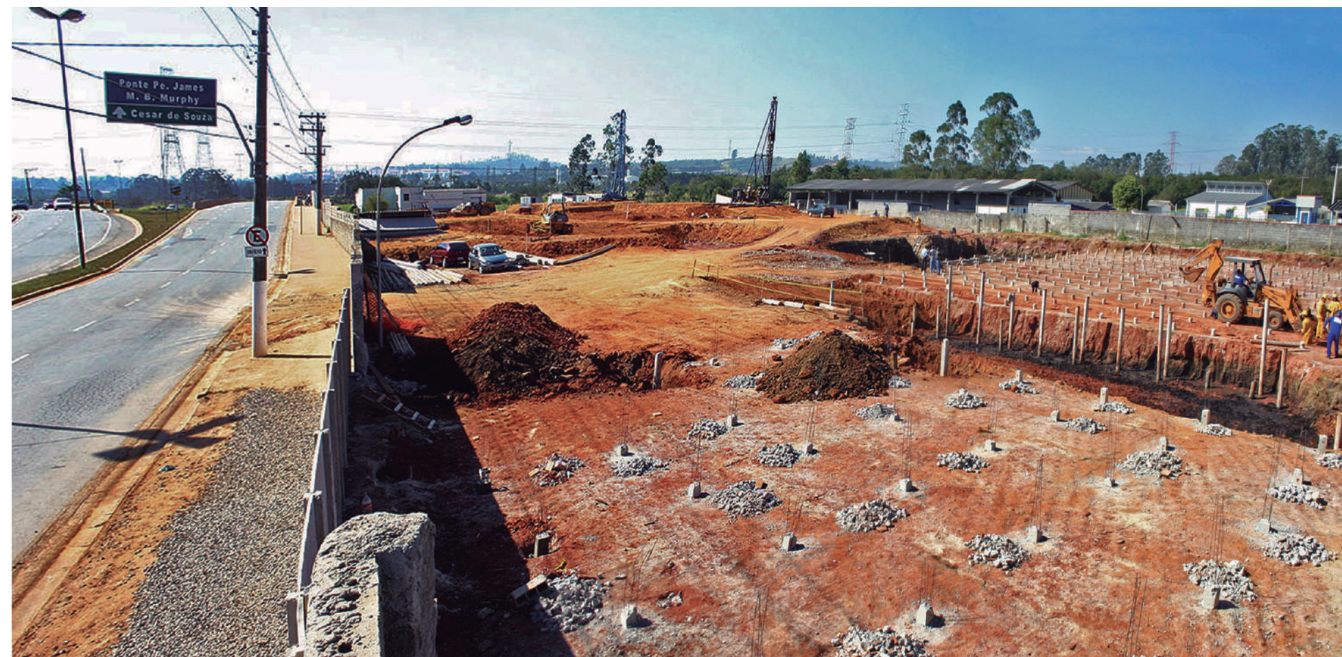
Execução das fundações da Estação de Tratamento de Água (ETA Leste), às margens da Avenida João XXIII, em 2005
